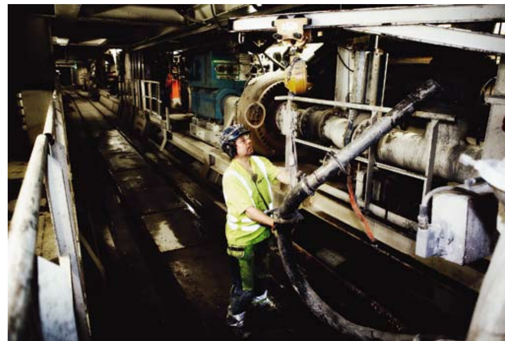
Arbetsmiljön inne i Hallandsåsen är extrem: bullrig, smutsig och med många oförutsebara scenarier. Här finns inte plats för några primadonnor, här måste man kunna lita på varandra. Mats ”MP” Persson platsar i laget.
